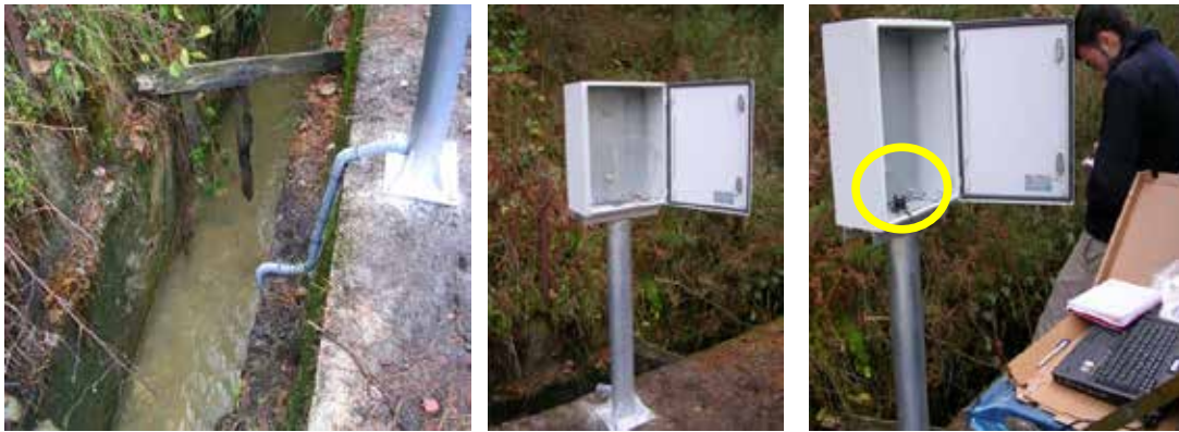
Foto 5. Limnógrafo instalado en el canal de Cereceo
